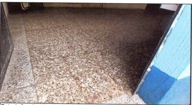
Foto 4: Sustrucción de piso cerámico debido a que el que se encuentra instalado se encuentra deteriorado.
